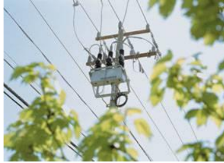
Figura - 19 - Equipo Seccionalizador
