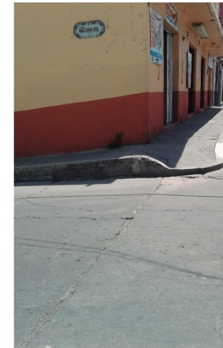
Fotografía 18. Banqueta no cuenta con las medidas adecuadas.
