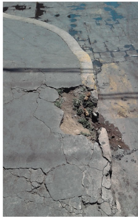
Fotografía 25. Intersección de la banqueta en deterioro y destrozada
