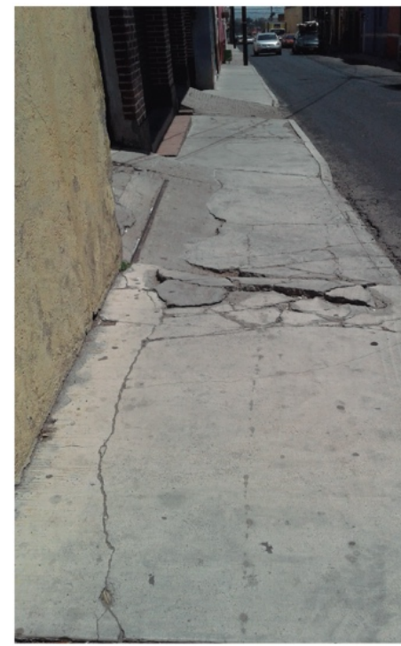
Fotografía 16. Banqueta en malas condiciones y tramos en desnivel en la calle
