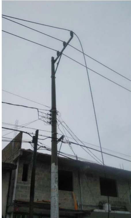
Figura 12.- Falla por ruptura de cable cubierto.
