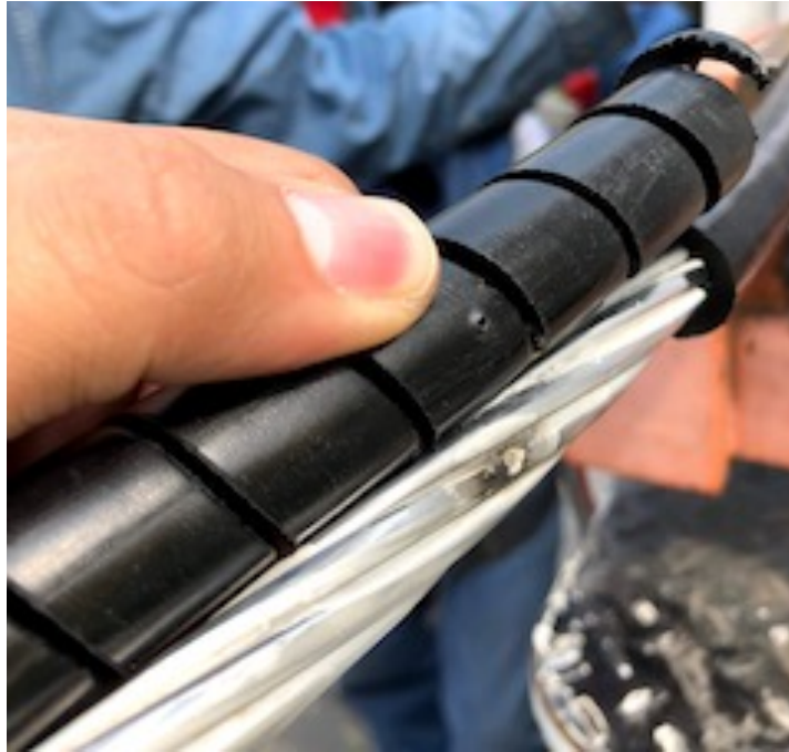
Figura 7.- Perforación en cubierta y conductor.
