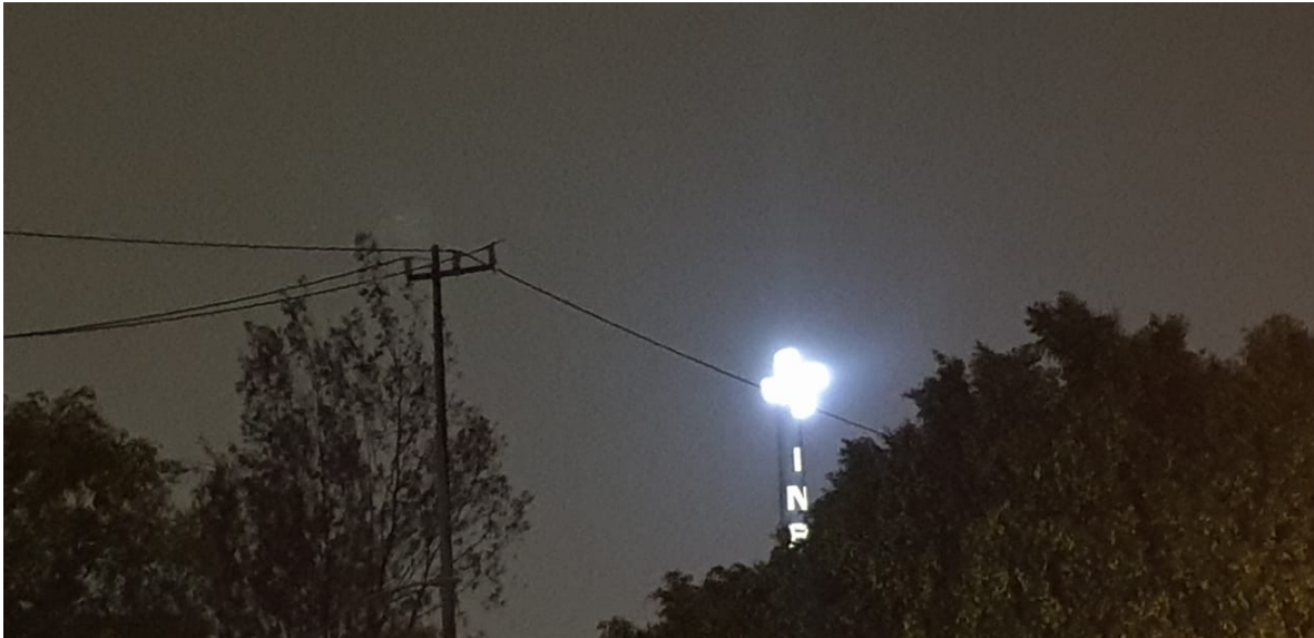
Figura 8.- Estructura de media tensión de paso con conductor caído.
