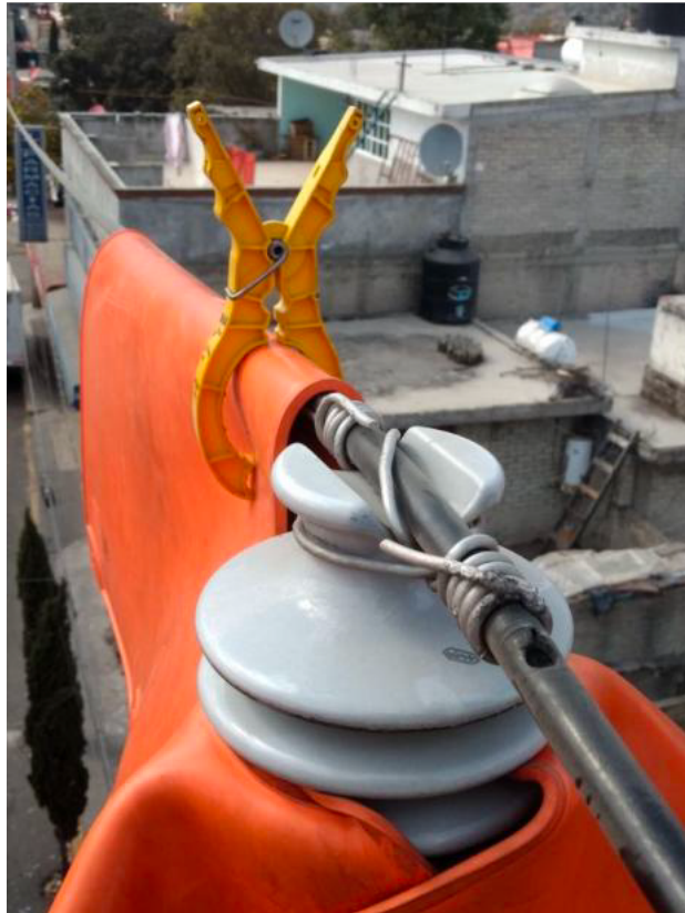
Figura 5.- Erosión en la zona de contacto cable cubierto con amarre de aluminio.
