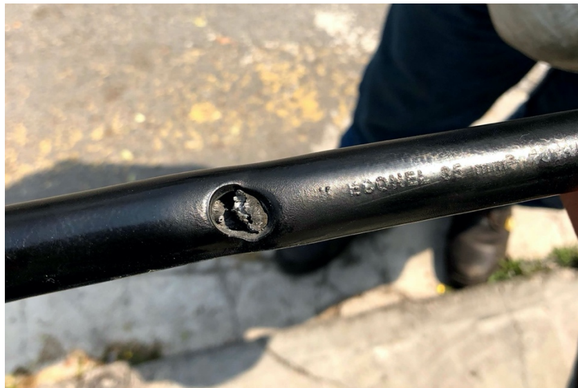
Figura 2.- Erosión en la cubierta de un conductor de media tensión.
