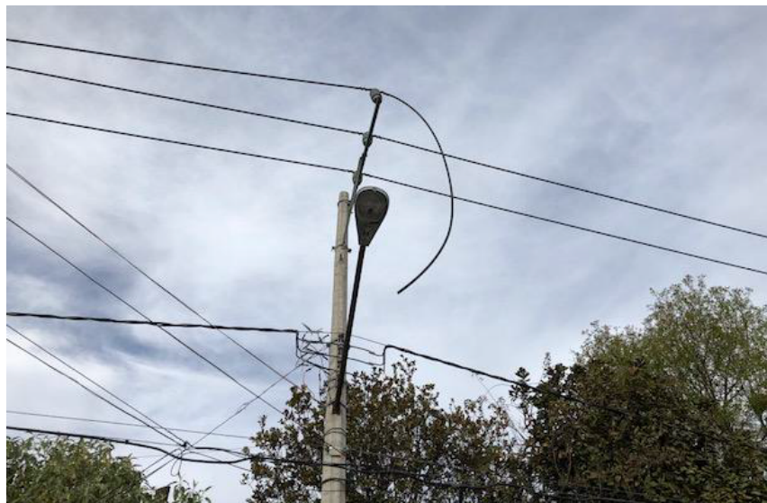
Figura 11.- Falla de cable cubierto, queda energizado después de liberar el arco por medio de seccionamiento automático.
