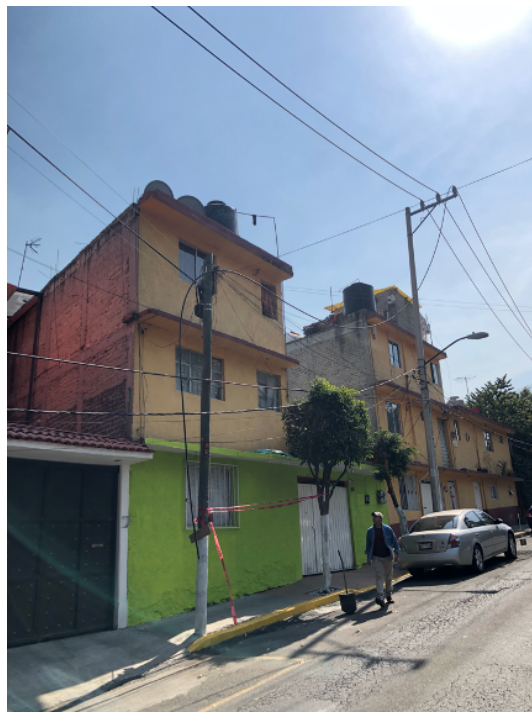
Figura 13.- Falla de cable cubierto, queda sobre poste de madera a una altura de 1.7m con respecto al nivel de piso.
