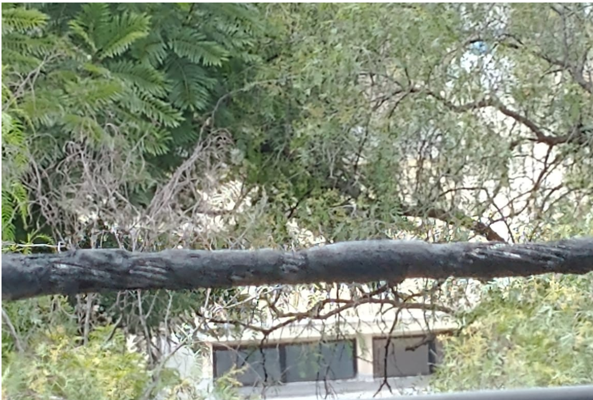
Figura 4.- Erosión en el conductor por contacto con ramas de árbol.
