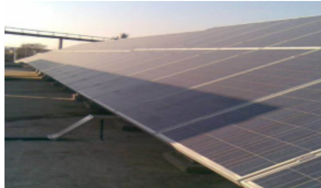
Figura 4.20: Sombreado parcial a mediodía en instalación fotovoltaica debido al cálculo incorrecto del distanciamiento entre las filas del arreglo [12].
