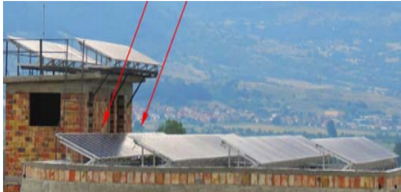
Figura 4.17: Sombreado parcial en instalación fotovoltaica debido a otra estructura que obstruye la luz solar a mediodía [12].
