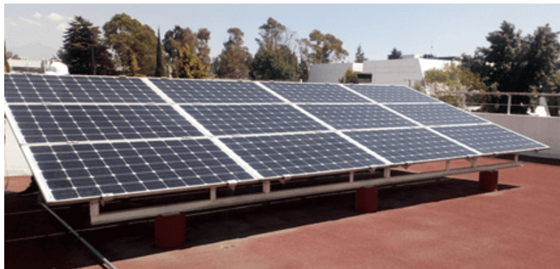
Figura 3.8: Arreglo fotovoltaico de la FCE.
