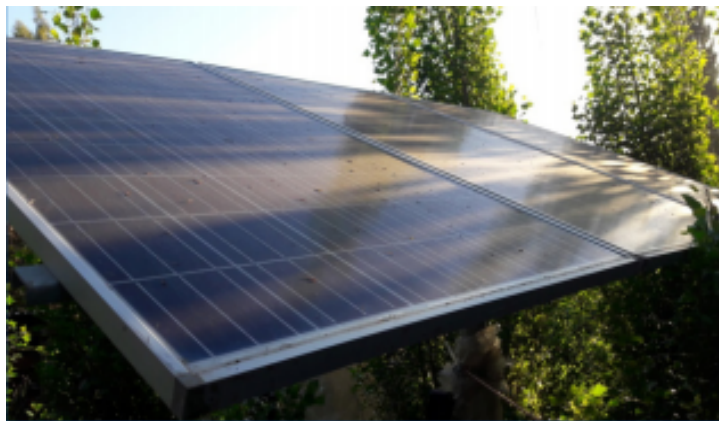
Figura 4.23: Sombreado parcial en instalación fotovoltaica debido a la vegetación que la rodea [12].
