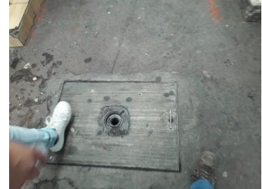
Imagen 22.. Registros sanitarios en pasillos
