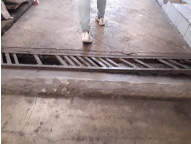
imagen 20. Rejillas pluviales en pasillos de circulación.
