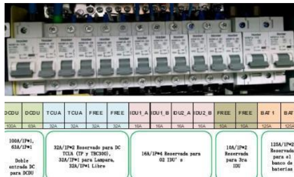
Figura H2 Rejilla de breakers
