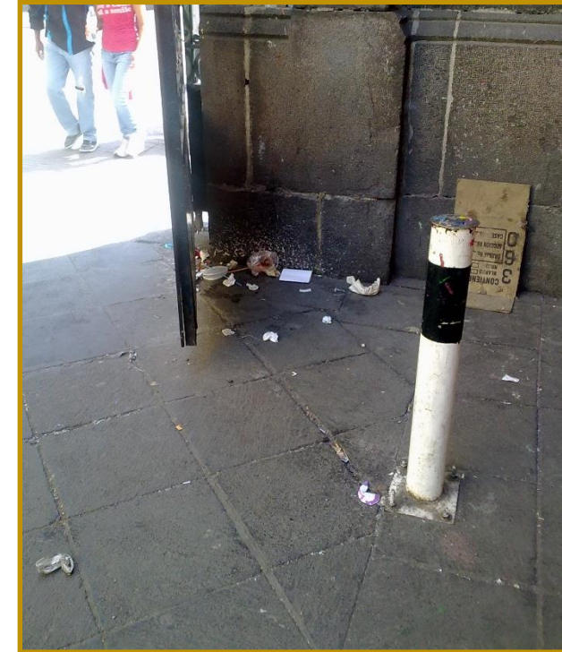
Alteración visual (basura) de fachada interior de acceso calle 5 de Mayo Centro Comercial "La Victoria", Centro Histórico de la Ciudad de Puebla. (2013)
