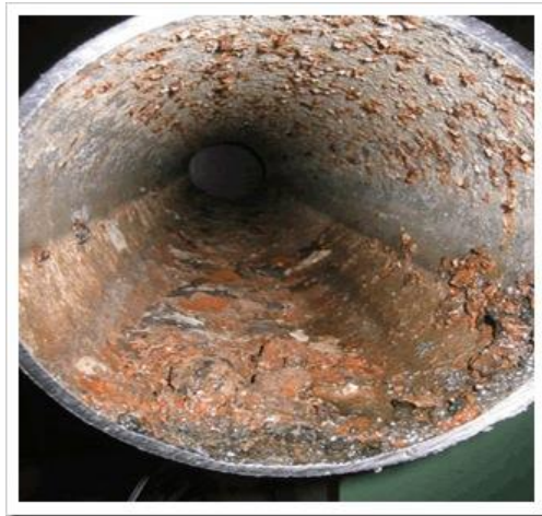
Figura 4. Corrosión por picadura
