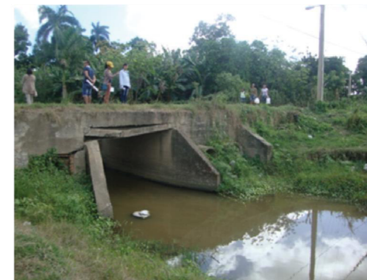
Este puente atraviesa el cauce del río Hatibonico, en la imagen se puede notar el deterioro del mismo. [Toma por Ángel Alberto Moreno Aguilar, el 19/02/2014]
