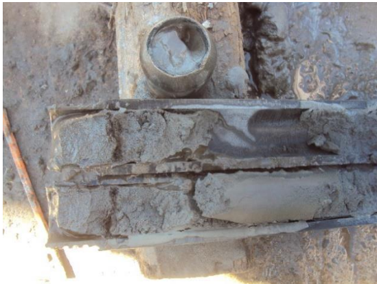
Recuperación de muestras alteradas del sondeo de penetración estándar para el diseño de la cimentación del Puente Barra Chaca Gorda.
