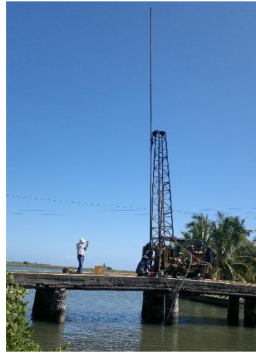
Trabajos de perforación de tipo penetración estándar para el diseño de la cimentación del Puente Barra Chaca Gorda.
