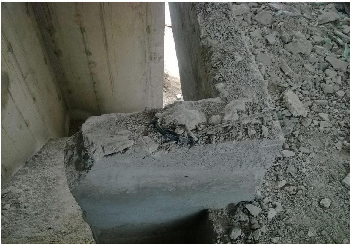
Fuente: propia, el acero expuesto, no debe pasar hay que checar las medidas del armado, Huejotzingo Puebla, ATV
