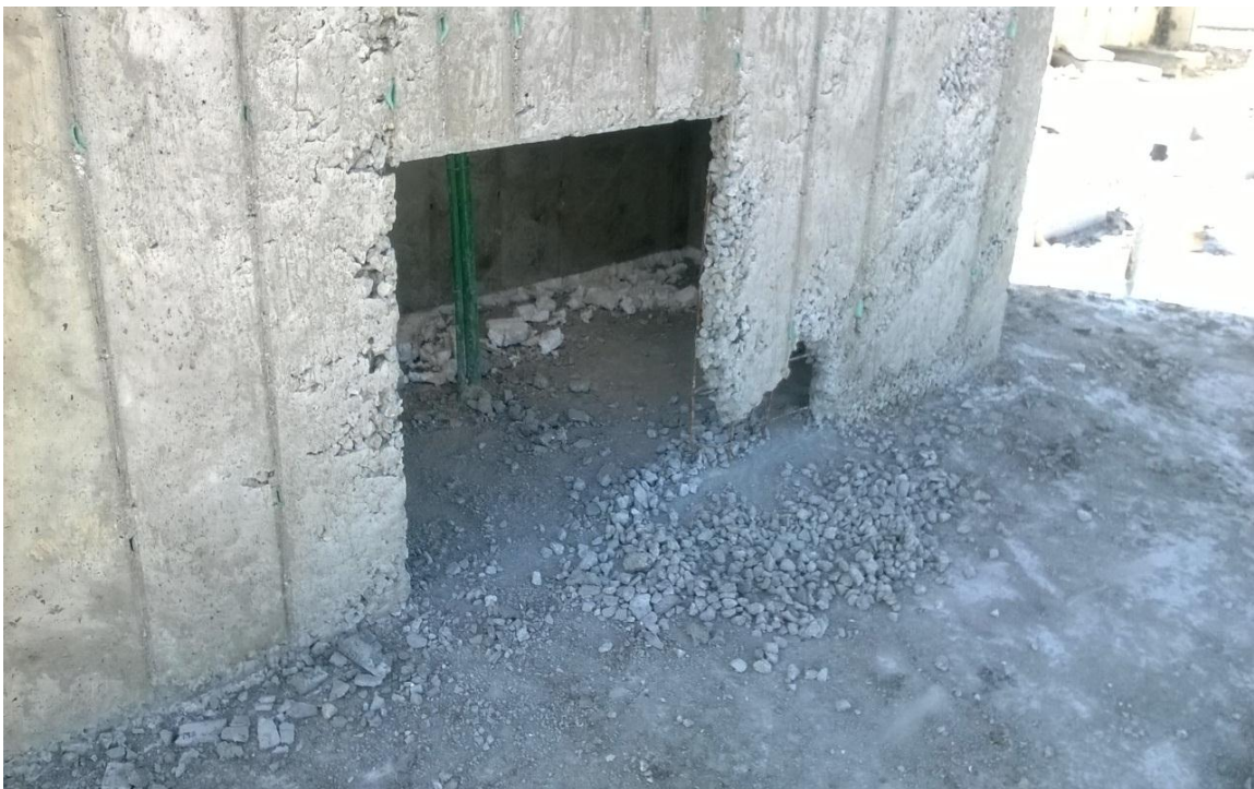
Fuente: propia, si el colado no bajo y hay acero expuesto, hay que colarlo inmediatamente, Huejotzingo Puebla ATV
