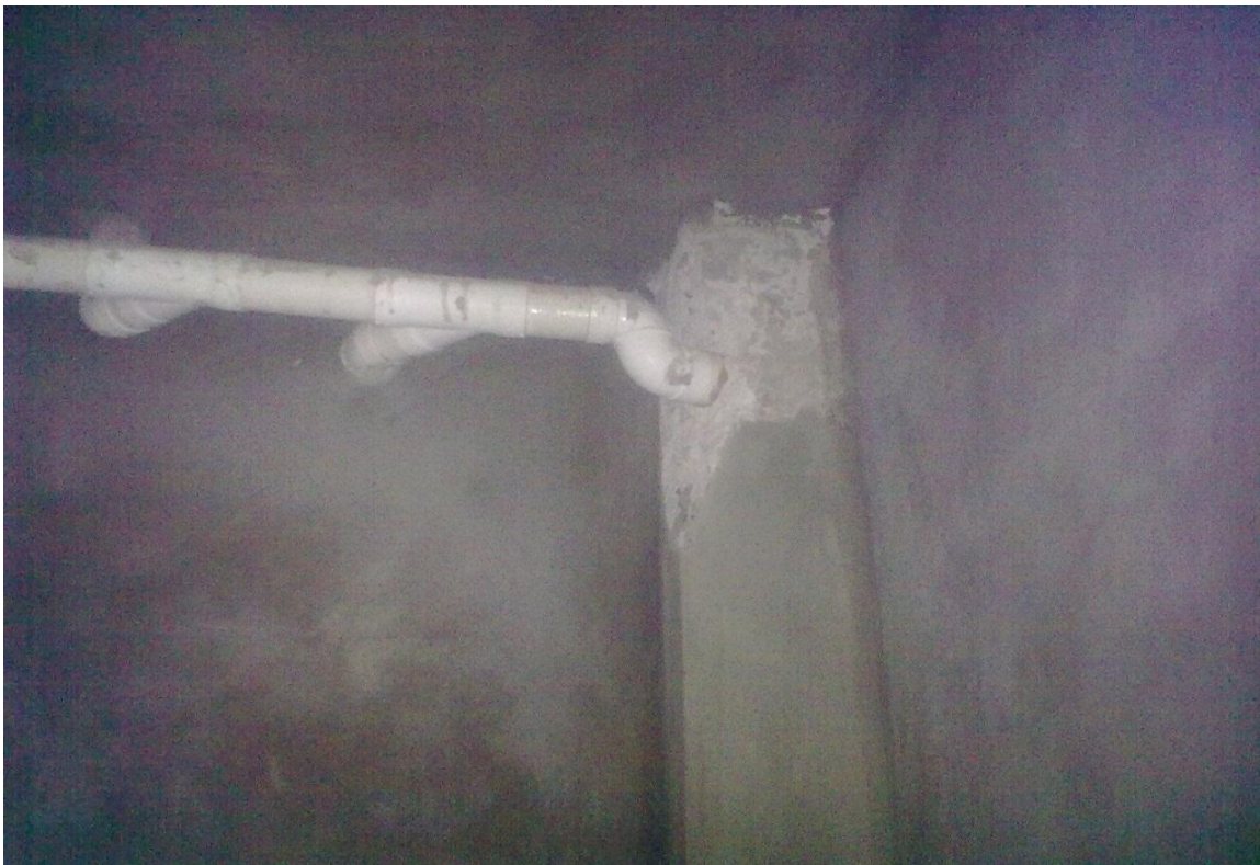
Fuente: propia, checar instalaciones, para no romper muros para encontrar tuberías, Huejotzingo Puebla ATV
