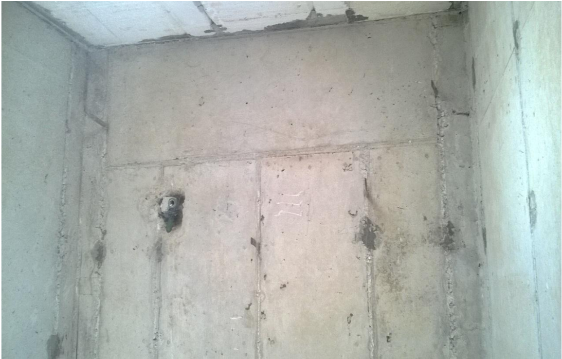
Fuente: propia, no deben quedar separadores del molde en los muros, es trabajo del murero, Huejotzingo Puebla, ATV
