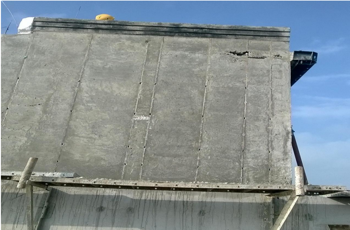
Fuente: propia, hay que resanar inmediatamente esos huecos en muros, Huejotzingo Puebla, ATV
