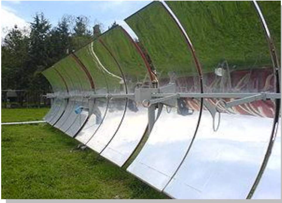
Fig.34.-PRODICASOL – 2010 – Termo solar de alta temperatura.
