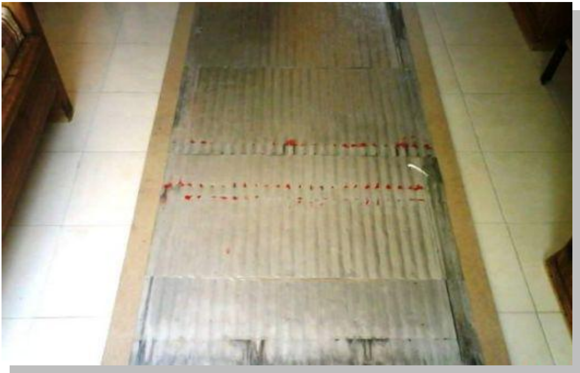
Fig.49.- ANGELES – 2010 - A la caja de madera hay que fijar los tramos de lámina Poli espuma.
