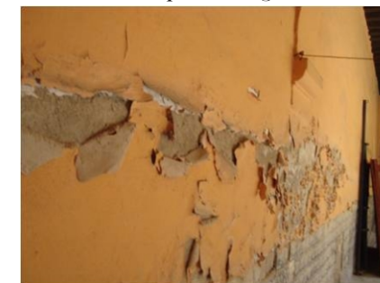
Ilus. 53 Pérdida de los aplanados y pintura
