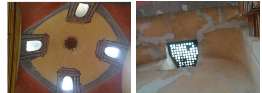
Ilus. 34 Vista interior de deterioros en cúpulas
