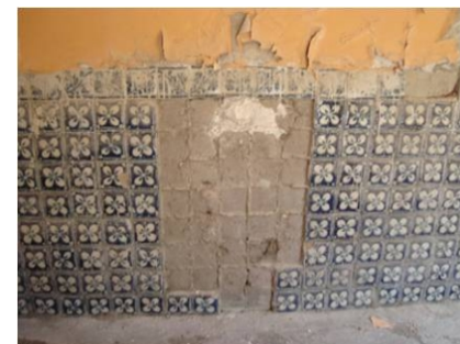
Ilus. 52 Pérdida de talavera en los muros
