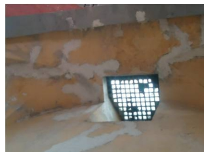
Ilus. 45 Deterioros en acabados
