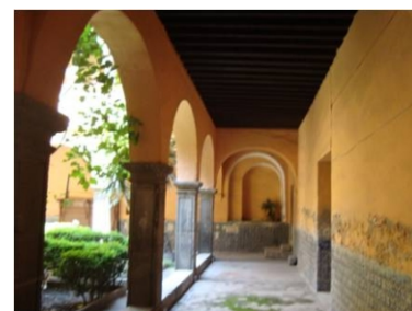
Ilus. 50 Deterioros en pasillos del claustro
