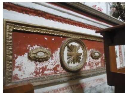
Ilus. 48 Desprendimiento de pintura
