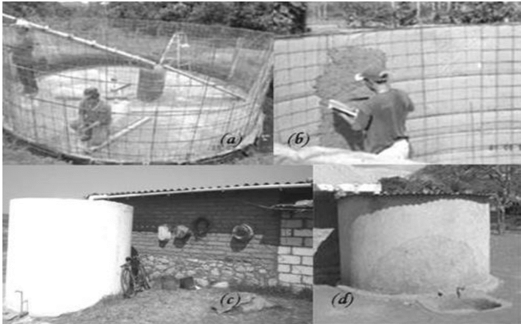
Fig. 2: Sistemas de Captación de Agua de Lluvia (SCALL) de Ferro-Cemento para comunidades rurales.
