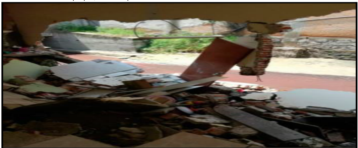
Fig.25 La fuerza de la corriente del río Álamos derrumbó el muro de una vivienda, el día 28 de junio de 2017. Fuente: Fonseca, 2017.
