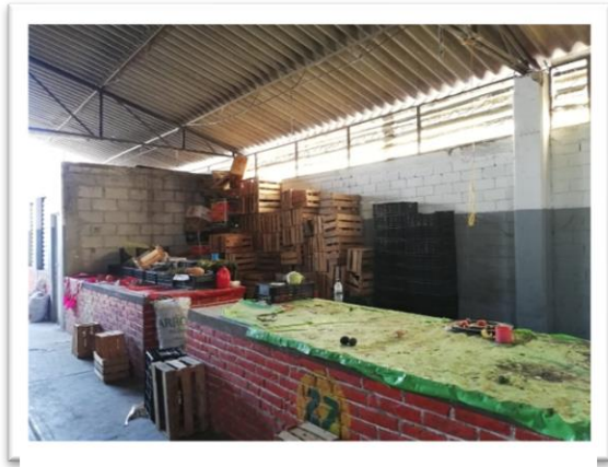
Figura 3. Deterioro del interior por falta de mantenimiento. Elaboración propia. (Palmar de Bravo Julio 2019).
