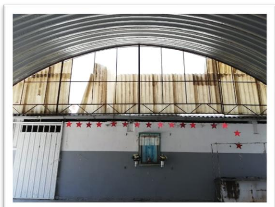
Figura 1. Deterioro de cubierta por daños naturales. Elaboración propia. (Palmar de Bravo Julio 2019).
