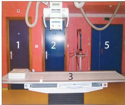
Figura 1.3: Sala de radiología convencional, 1 y 2 cabinas, 3 mesa de examen y 5 sala de control[8].
