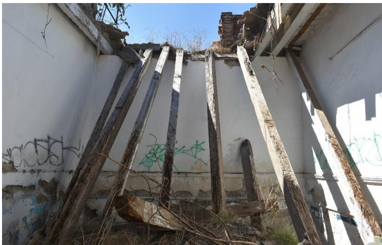
Losa colapsada en la parte posterior del edificio (imagen propia)
