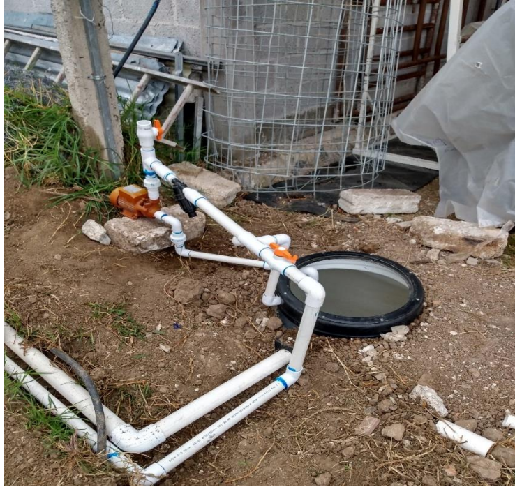
Figura 9. Instalación de sistema de riego utilizado para el sistema hidropónico NGS®
