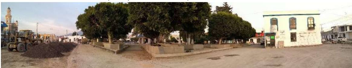
[Foto 74] Panorámica del centro histórico del municipio de Amozoc, en esta foto se puede apreciar el avance de obra del zócalo del mismo, se carece de firme y no se distingue el límite del mismo respecto al de la calle. La zona desde donde se tomó la fotografía era una de las principales “rampas” donde se reunían las personas para practicar skateboarding. Tlahuetl, Y. diciembre 2016.
