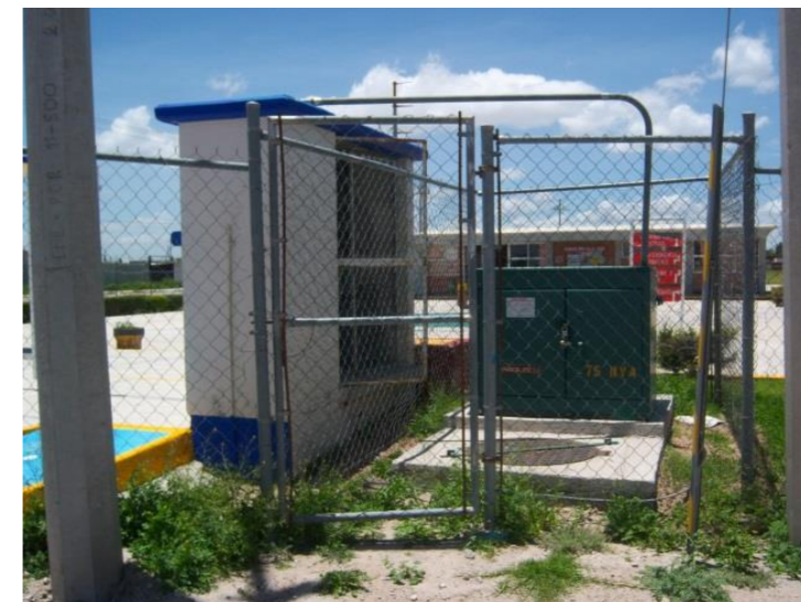
SERVICIOS DE DENAJE Y LUZ ELECTRICA FOTOS: SAMUEL CORDERO AGULAR
