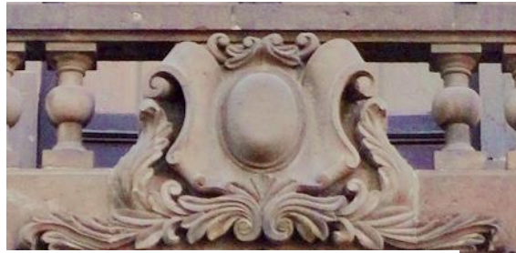
Ilustración 162. Detallé del balcón de la casa #22 de la acera norte en la calle de Miradores. (Fotografía KGM)
