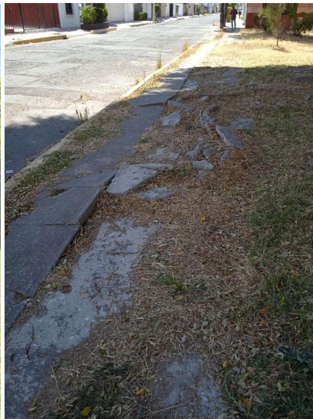
Figura 4. Condiciones de difícil tránsito peatonal y accesibilidad a las áreas verdes. Foto de Arq. Juan Carlos Montes Pesquera.
