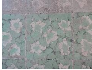
IMAGEN 28.5 Muestra de Loseta Fuente: Visita 09 de Noviembre 2017
