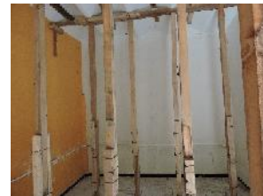
IMAGEN 12.1 Muros con Humedades Fuente: Visita 09 de Noviembre 2017
