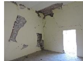
IMAGEN 19.3 Daños en Muros Fuente: Visita 09 de Noviembre 2017
