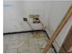
IMAGEN 11.4 Deterioro en Muro Fuente: Visita 09 de Noviembre 2017
