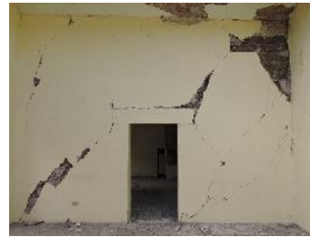
IMAGEN 20.5 Muro Dañado Fuente: Visita 09 de Noviembre 2017
