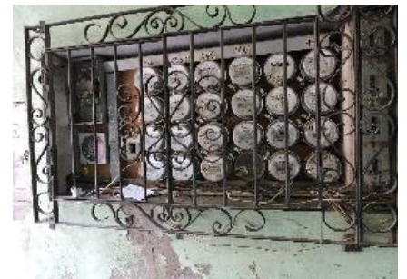
IMAGEN 2.2 Tablero Principal Fuente: Visita 15 de Septiembre 2017
