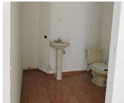
IMAGEN 3.4 Humedades en Muro Fuente: Visita 09 de Noviembre 2017
