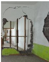
IMAGEN 21.4 Muro Colapsado Fuente: Visita 09 de Noviembre 2017
