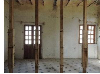
IMAGEN 23.3 Balcones al Patio 2 Fuente: Visita 09 de Noviembre 2017
