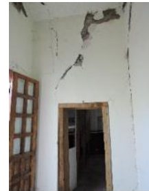
IMAGEN 27.1 Daños en Muro
