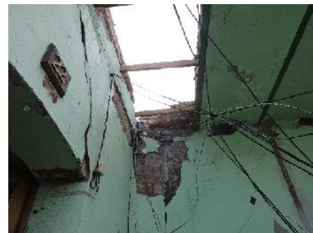
IMAGEN 18.3 Colapso de Losa
