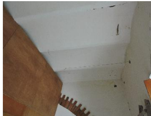
IMAGEN 4.3 Humedades en Losa Fuente: Visita 15 de Septiembre 2017
