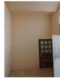
IMAGEN 9.1 Muro Divisorio Fuente: Visita 09 de Noviembre 2017
