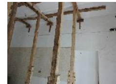
IMAGEN 7.1 Humedades en Muro Fuente: Visita 09 de Noviembre 2017
