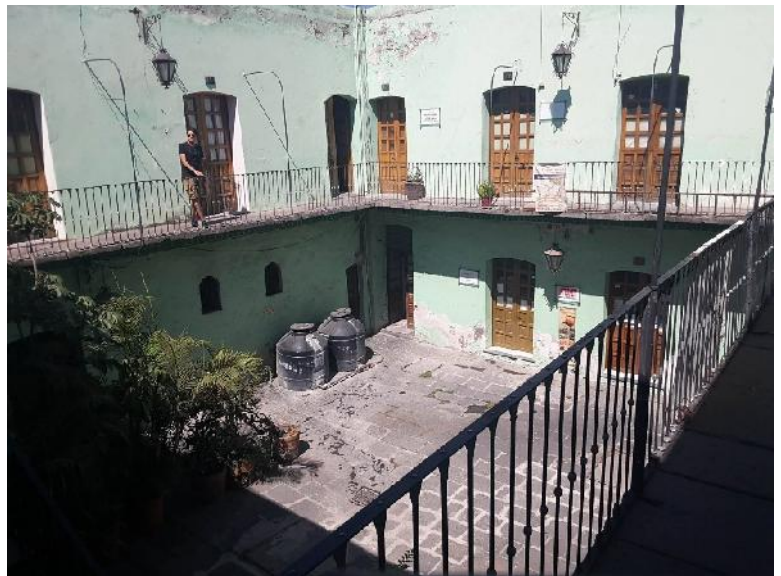
IMAGEN 3: Patio Central, muestra deterioro por la humedad en los muros Fuente: Visita de Campo– Hernández, López, Sánchez
