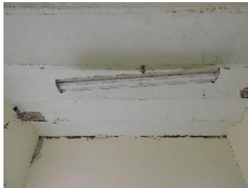
IMAGEN 19.4 Daños en Losa Fuente: Visita 09 de Noviembre 2017
