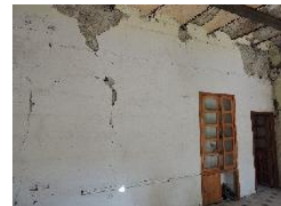
IMAGEN 23.1 Muro Divisorio Fuente: Visita 09 de Noviembre 2017
