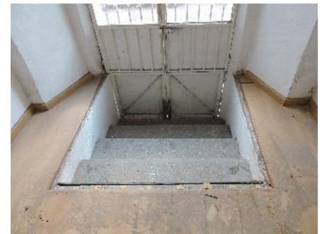
IMAGEN 3.5 Humedades en Muro y Piso Laminado Fuente: Visita 09 de Noviembre 2017
