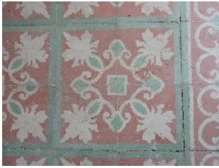
IMAGEN 28.4 Muestra de Loseta Fuente: Visita 09 de Noviembre 2017
