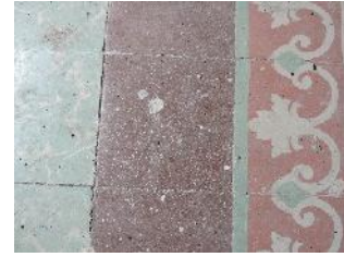
IMAGEN 28.6 Muestra de Loseta Fuente: Visita 09 de Noviembre 2017
