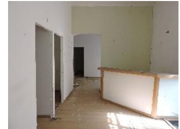
IMAGEN 3.1 Muro Divisorio Fuente: Visita 09 de Noviembre 2017
