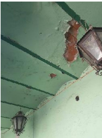
Fig.1 Muestra de desprendimiento del acabo en el techo Fuente: Visita de Campo 08/07/17
