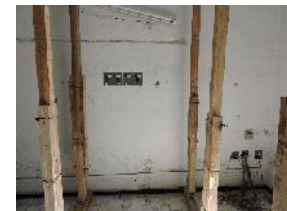
IMAGEN 11.2 Instalaciones Fuente: Visita 09 de Noviembre 2017
