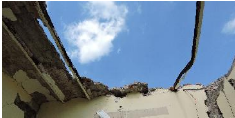
IMAGEN 20.4 Losa Colapsada Fuente: Visita 09 de Noviembre 2017
