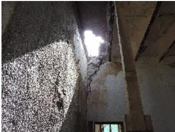
IMAGEN 23.5 Colapso de Losa Fuente: Visita 09 de Noviembre 2017
