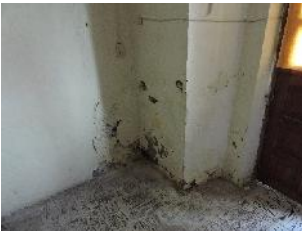
IMAGEN 5.2 Humedades en Muro Fuente: Visita 09 de Noviembre 2017
