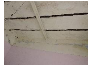
IMAGEN 28.7 Humedad en Losa Fuente: Visita 09 de Noviembre 2017
