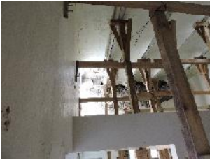
IMAGEN 27.3 Daños en Muro y Losa
