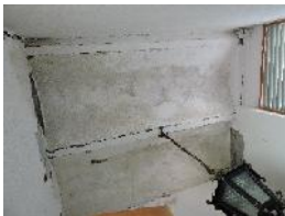
IMAGEN 26.2 Humedad en Losa Fuente: Visita 09 de Noviembre 2017
