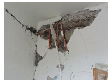
IMAGEN 21.4 Daños por Instalaciones Fuente: Visita 09 de Noviembre 2017
