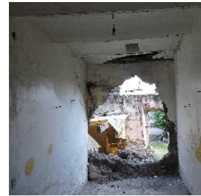
IMAGEN 8.3 Colapso de Muro Fuente: Visita 09 de Noviembre 2017
