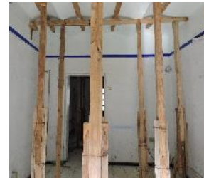
IMAGEN 11.1 Muro Divisorio Fuente: Visita 09 de Noviembre 2017
