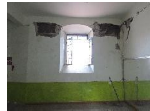
IMAGEN 21.1 Ventana y Daños en Muro Fuente: Visita 09 de Noviembre 2017
