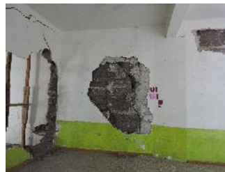
IMAGEN 21.4 Daños en Muro Fuente: Visita 09 de Noviembre 2017
