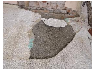
IMAGEN 23.7 Daños en Recubrimientos Fuente: Visita 09 de Noviembre 2017
