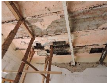
IMAGEN 23.6 Colapso de Losa Fuente: Visita 09 de Noviembre 2017
