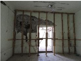
IMAGEN 22.4 Muro Dañado Fuente: Visita 09 de Noviembre 2017
