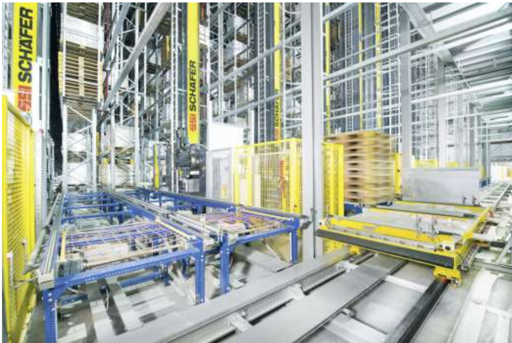
Figura 20: Transelevador EXYZ; Stacker Crane SSI Schäfer.
