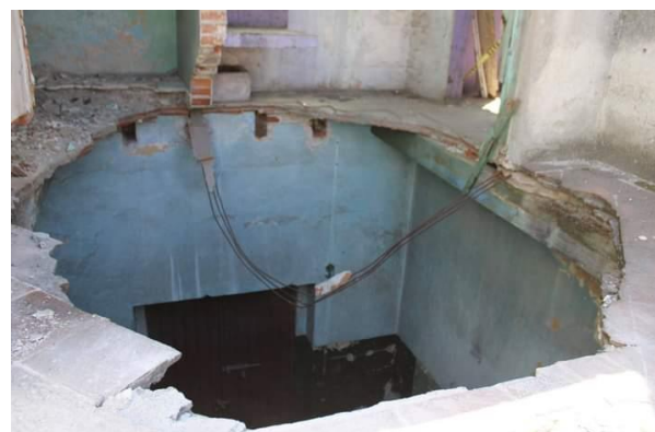
Imágen 5.4 Colapso de losa en la “sala de música” Fuente: Archivo propio
