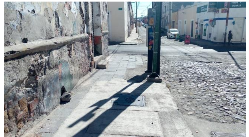
Fotografía 2.30 Área peatonal en mal estado, falta de guías podotáctiles, rampas y señalética en sistema braille. ( esquina 14 sur y 7 oriente Barrio de Analco) Fuente: Archivo propio
