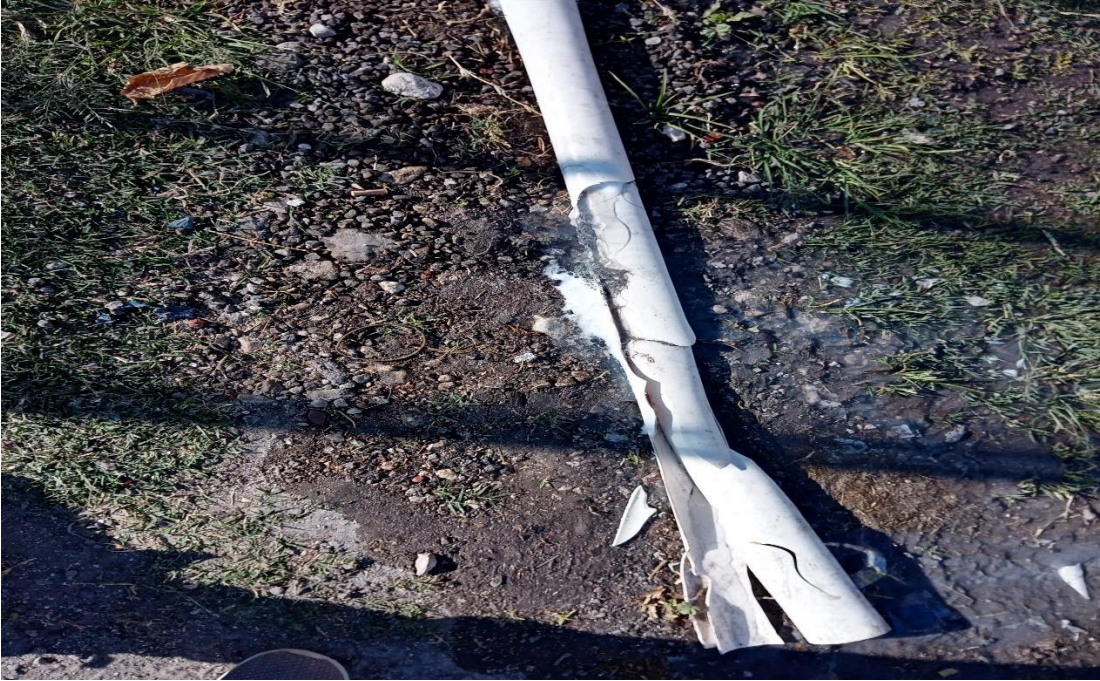
Desagüe de aguas residuales domésticas a campo abierto
