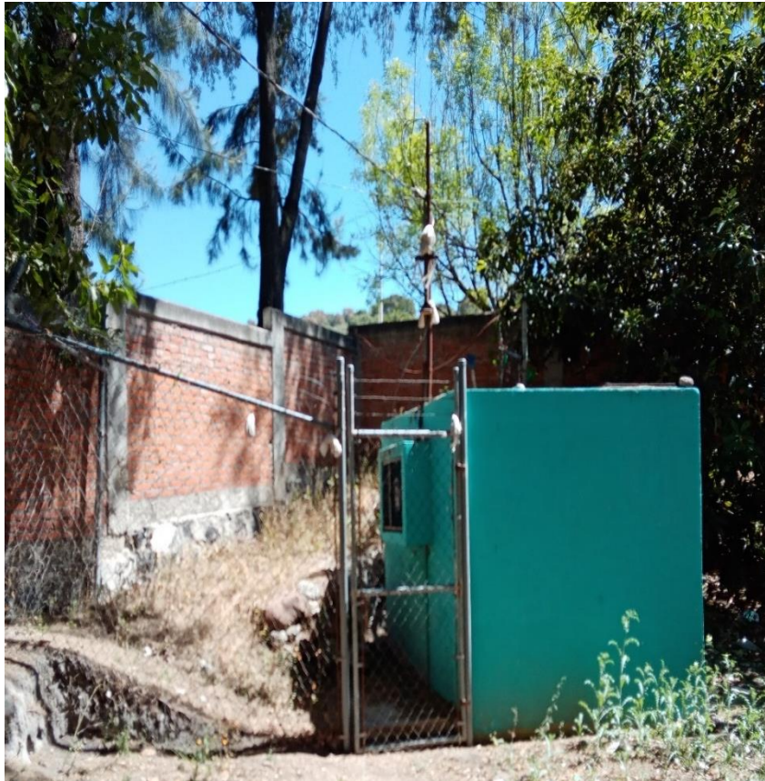
Figura 7. Cuarto de pozo de agua subterránea.
