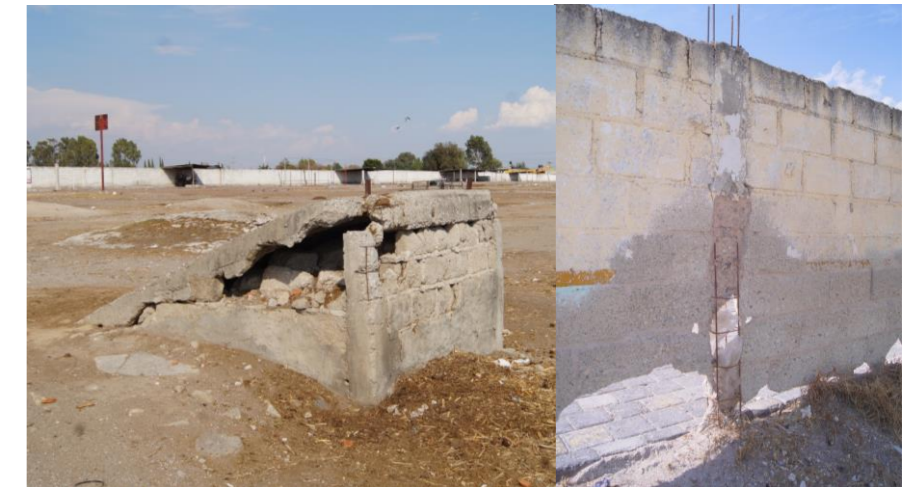
Figura 3. Deterioro en Rampa Fija y Bardas perimetrales. Foto tomada por De la Cruz Palacios, Jesús Emmanuel (2017).
