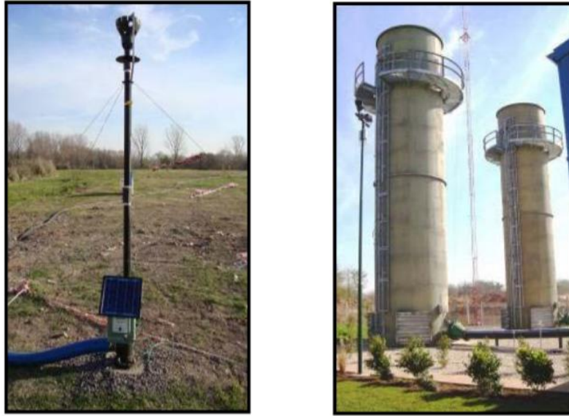
Figura 2.5 Quemadores de antorcha elevada y antorcha cerrada. [6]
