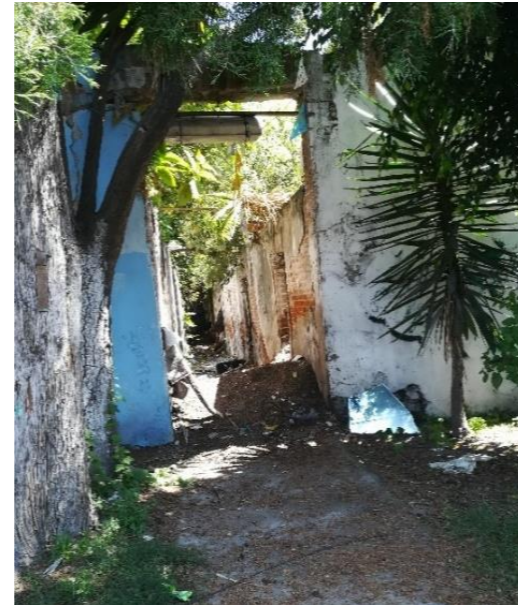
4.2.2.1) Inmueble abandonado en avenida 22 poniente / Propia
