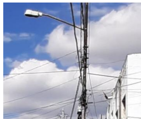
4.2.3.1) Luminaria sin lámpara en Calle 7 norte / Propia
