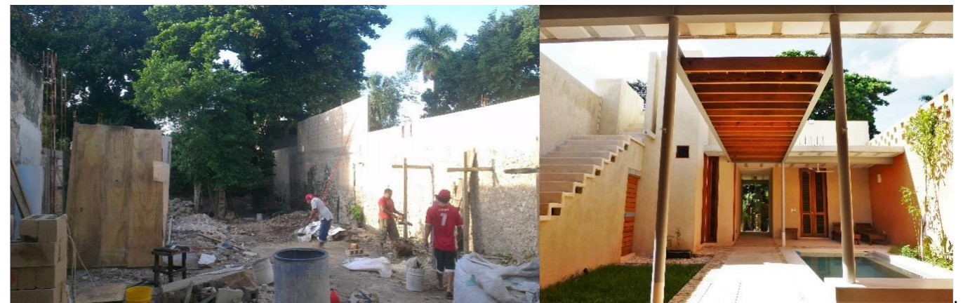
1.4/1.5/1.6/1.7/1.8/1.9/1.10) Proyecto de restauración e intervención, casa "La Mejorada", Mérida, Yucatán. (Yagué, 2014). Editorial RESTAURO / https://editorialrestauro.com.mx/intervencion-de-la-vivienda-en-el-centro-historico-de-merida/
