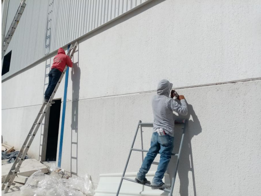
Figura 4.22 Se utilizaron paneles de hormigón para las paredes de la nave industrial, seguidos de lámina PINTRO C-42 Cal. 26.
