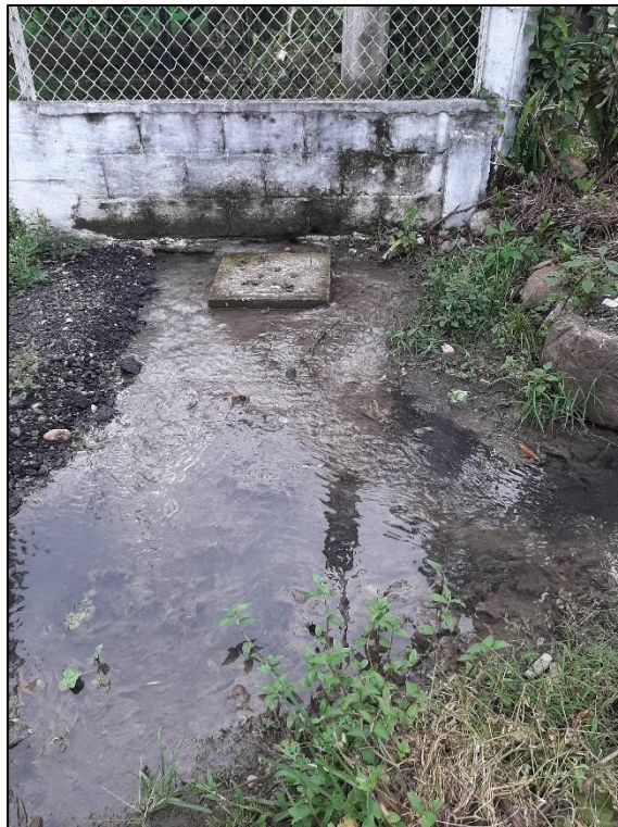
Fig. 48 Salida de agua residuales de registro en la calle afectada.
