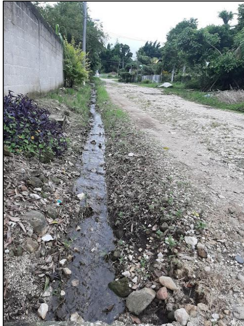
Fig. 46 Escurrimiento de aguas residuales por zanja de la calle Julián Gutiérrez. Fuente: Elaboración propia.
