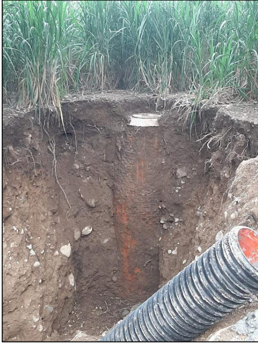
Fig. 60 Excavación de pozo de visita 14 para realizar la conexión con la tubería.
