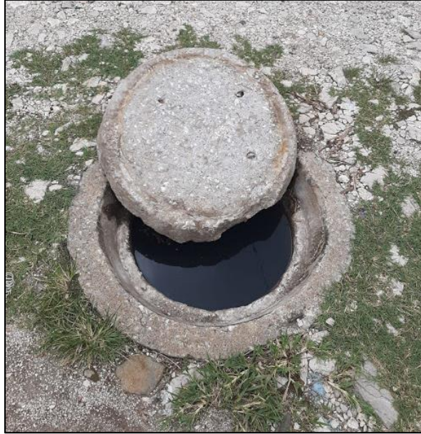
Fig. 47 Pozo de visita con capacidad máxima, ubicado en la calle Julián Gutiérrez.
