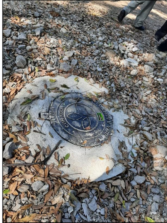
Fig. 58 Tapa para olla que conecta al pozo de visita 14.
