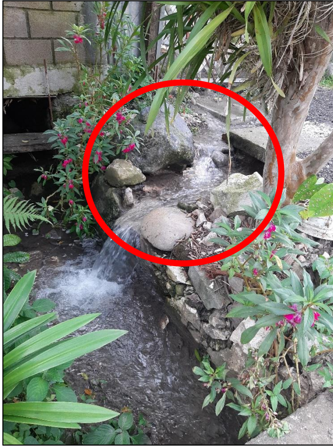
Fig. 49 Salida de aguas residuales de un registro de la calle afectada.
