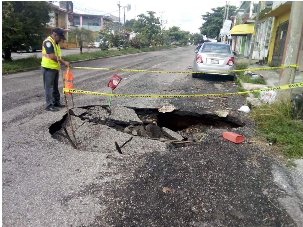
Ilustración 44. Socavón en la colonia José Eduardo en Cárdenas, Tabasco. Fuente propia de la investigación, 2020.
