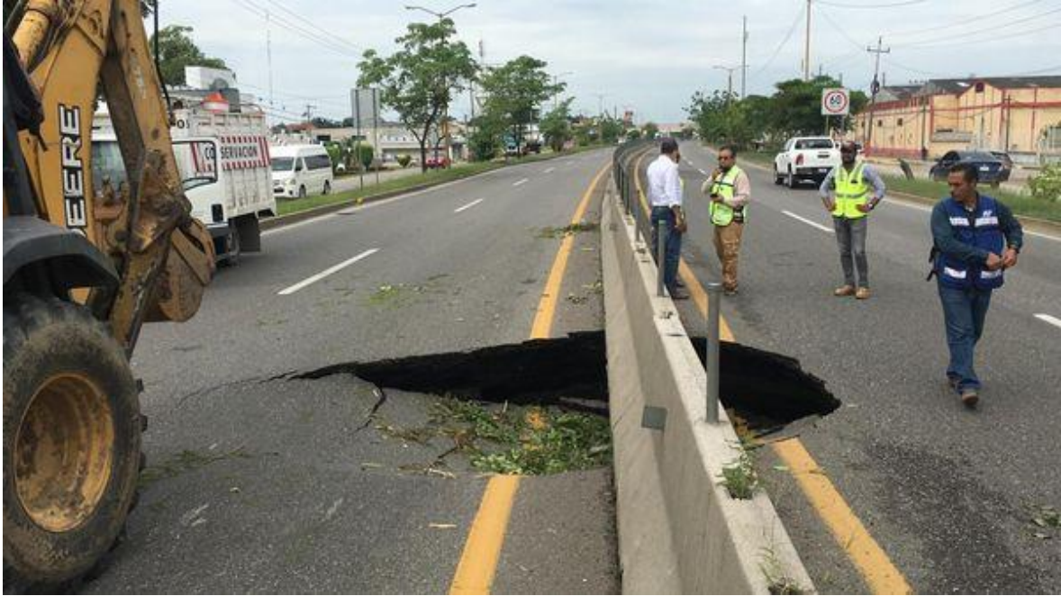
Ilustración 43. Socavón en la carretera Villahermosa-Cárdenas. Trabuco Noticias, 2020.
