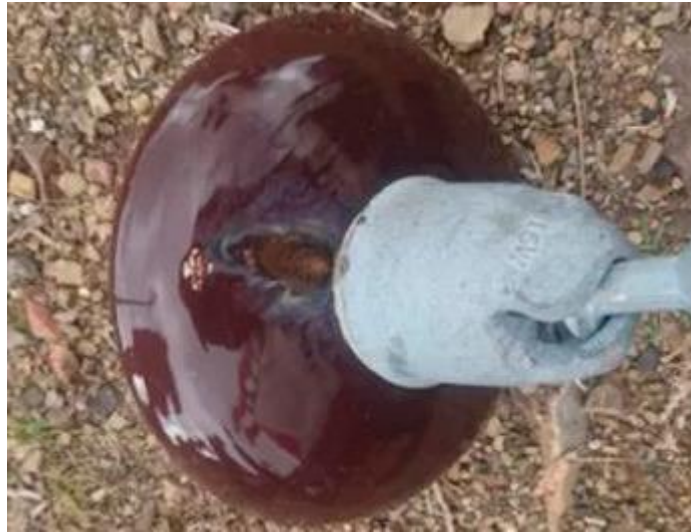
Figura 1.7. Aislador con evidencia de una descarga atmosférica. Ilustración 7 [16]
