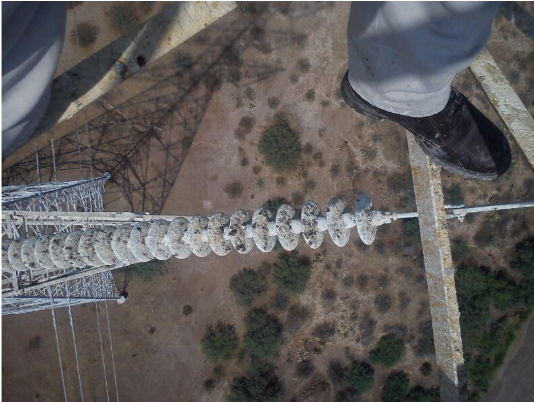
Figura 1.4 Revisión física de aislamiento contaminado en LT de 230 kV [9]
