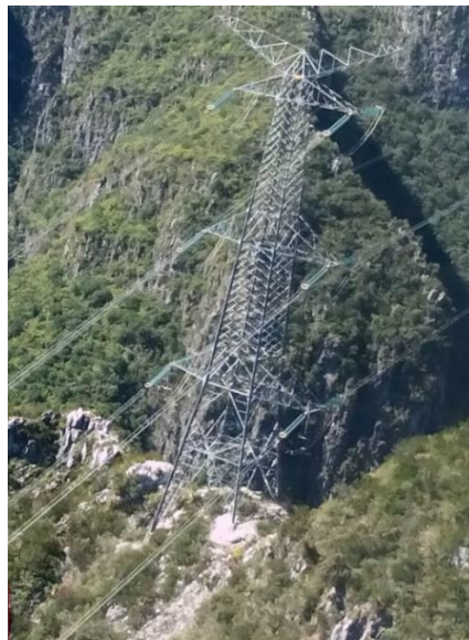
Figura 1.3. Línea de Transmisión de 400 kV en zona montañosa de la República Mexicana. [8] Ilustración 3
