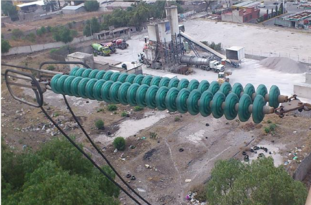
Figura 3.5.8 Aislamiento contaminado detectado con Equipos de detección de onda viajera. Ilustración 266 [56]
