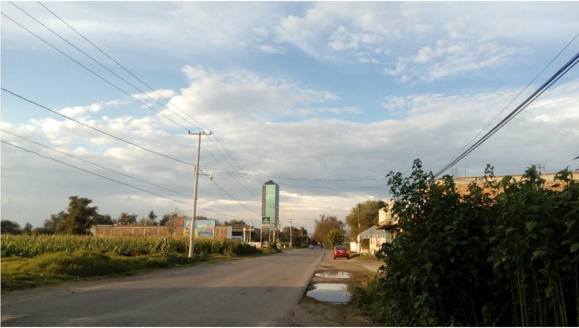
Figura 37. La banqueta es de tipo terracería, presenta gran deterioro y se ve afectada por las inundaciones.
