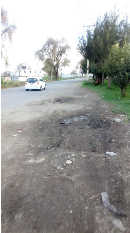
Figura 34. La avenida presenta serios problemas de inundación a las afueras del Plantel F-18.
