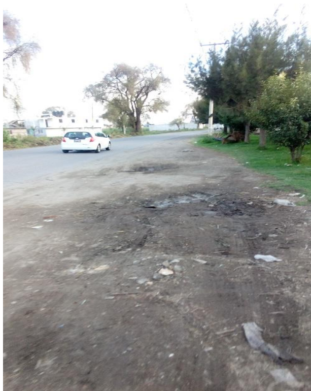
Figura 18. La avenida presenta serios problemas de inundación a las afueras del Plantel F-18.
