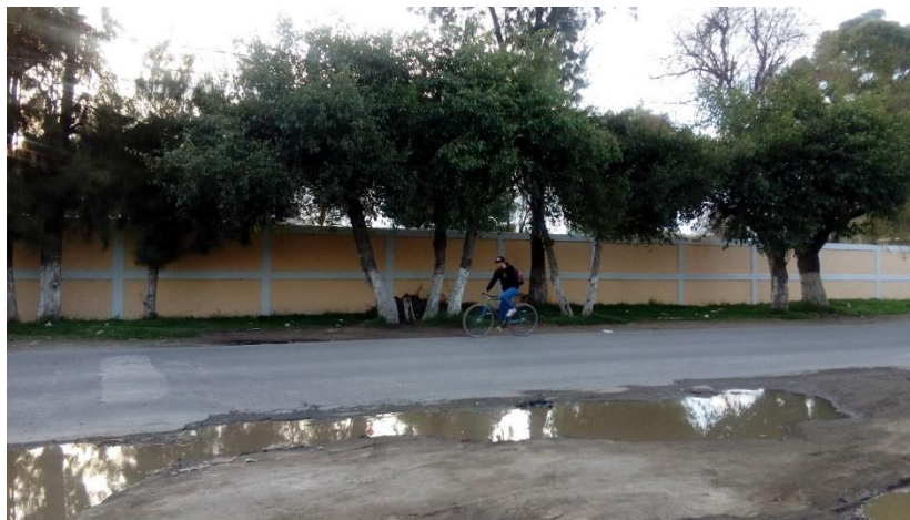
Figura 19 Las banquetas presentan graves inundaciones lo cual no permite un tránsito seguro para los peatones.
