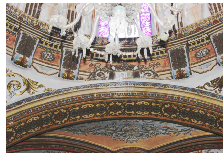
Figura 3. Manchas y desprendimientos de pintura a la cal por presencia de humedad en clave de arco fajón bajo cúpula (Autor: Luis Gutiérrez, 2021).
