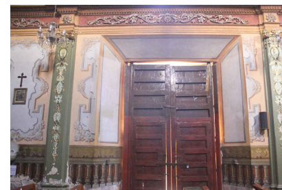
Figura 2. Pérdida de pintura en muros. Manchas en pintura a la cal por presencia de humedad (Autor: Luis Gutiérrez, 2021).
