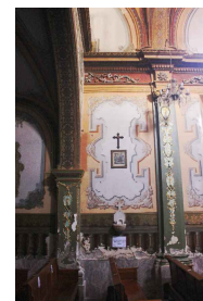
Figura 1. Pérdida de aplanados y de pintura en muros por presencia de humedad por capilaridad (Autor: Luis Gutiérrez, 2021).
