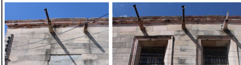
Fig. 1-2. Pérdida de gárgolas en fachada sur. Autor: Luis Gutiérrez, 2021.
