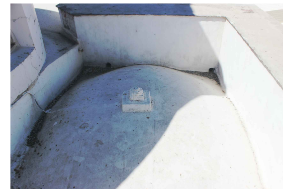
Figura 3. Depósitos de guano de paloma en proximidad de los desagües en extradós de bóvedas (Autor: Luis Gutiérrez, 2021).
