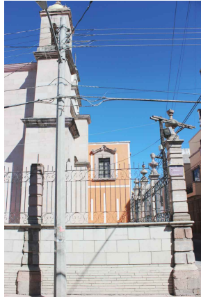
Figura 1. Pérdida de pináculo de piedra sobre pilar. Formación de microflora en cornisas de barda atrial e instalaciones expuestas (Autor: Luis Gutiérrez, 2021).
