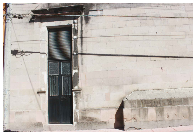
Figura 1. Formaciones de microflora y descamación de laminados de piedra en fachada de sacristía (Autor: Luis Gutiérrez, 2021).
