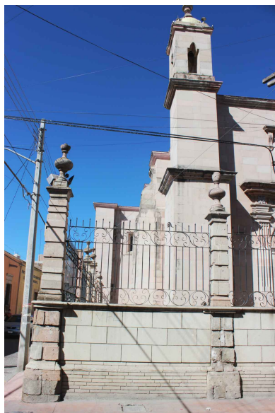
Figura 3. Fisuras en laminados de piedra de pilares y formaciones de microflora en cornisa en barda atrial (Autor: Luis Gutiérrez, 2021).
