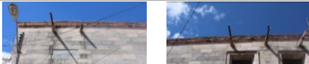
Fig. 1 - 2. Gárgolas con pérdida de emboquillado. Autor: Luis Gutiérrez, 2021.
