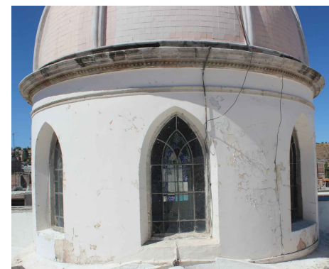
Figura 2. Fisuras y desprendimiento de pintura vinílica e instalaciones expuestas en paño exterior de tambor de cúpula (Autor: Luis Gutiérrez, 2021).
