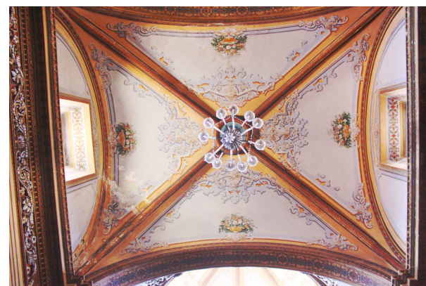
Figura 2. Manchas, fisuras y desprendimientos de pintura a la cal por presencia de humedad en intradós de bóveda de nave (Autor: Luis Gutiérrez, 2021).
