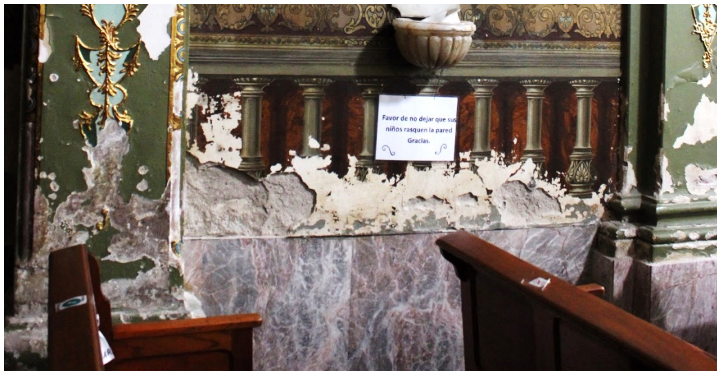
Figura 5. Disgregación de morteros y pérdida de pintura mural por presencia de humedad por capilaridad (Autor: Luis Gutiérrez, 2021).
