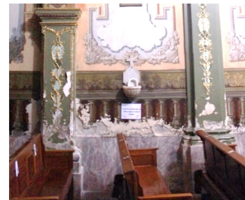
Figura 83. Pérdida de pintura mural y disgregación de morteros por presencia de humedad por capilaridad. (Autor: Luis Gutiérrez, 2021).
