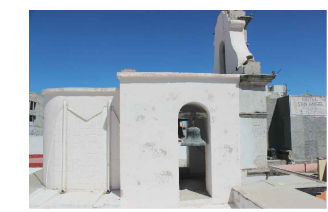
Figura 2. Fisuras y abombamientos de pintura vinílica, depósitos de guano y corrosión en campanas (Autor: Luis Gutiérrez, 2021).
