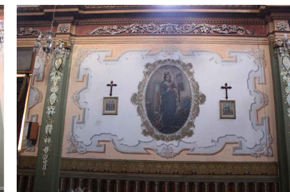
Figura 3. Desprendimientos y manchas en pintura mural por presencia de humedad (Autor: Luis Gutiérrez, 2021).
