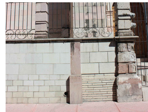
Figura 2. Formaciones de microflora en cornisa y descamación de laminados de piedra en barra atrial (Autor: Luis Gutiérrez, 2021).
