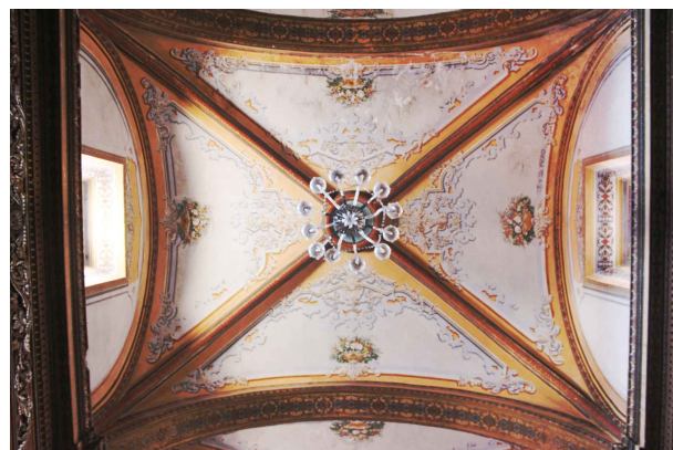
Figura 1. Manchas, fisuras y desprendimientos de pintura a la cal por presencia de humedad en intradós de bóveda de nave (Autor: Luis Gutiérrez, 2021).
