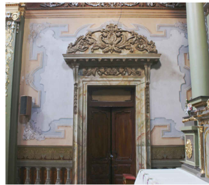
Figura 2. Instalaciones expuestas en muro poniente de transepto (Autor: Luis Gutiérrez, 2021).
