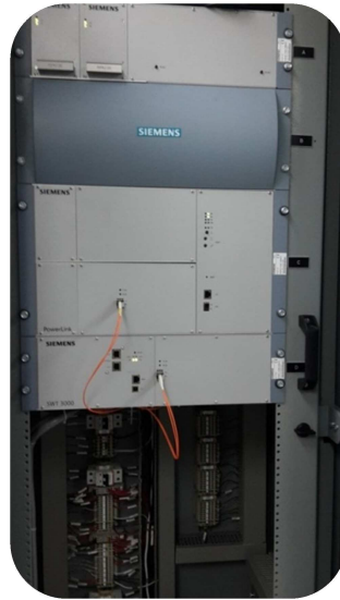
Fig. 2.2 Modelo Equipo OPLAT Power Link Y Teleprotección SWT 3000.
