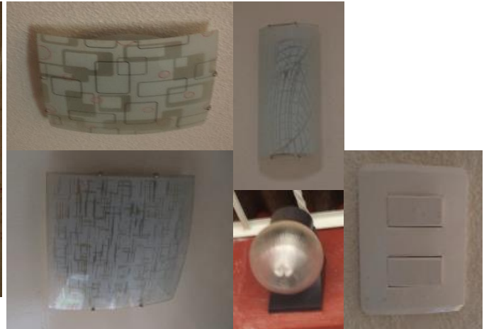
Iluminarias y apagadores
