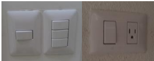
Contactos y apagadores
