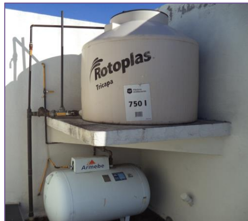
Tinaco y tanque estacionario
