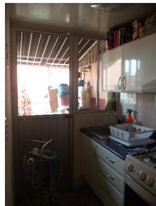
Puerta bandera de aluminio en cocina-patio de servicio
