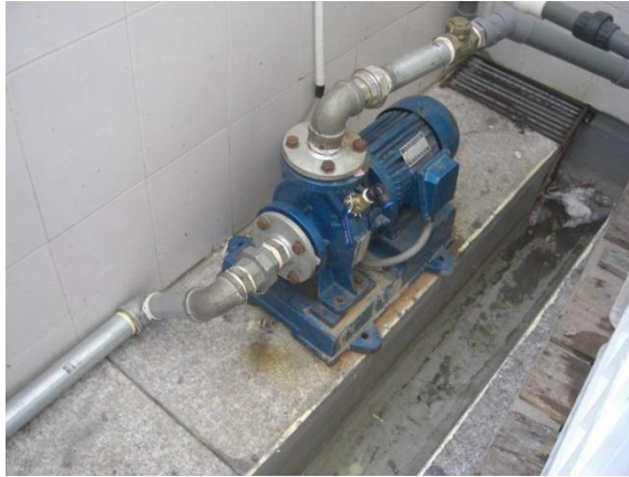
Figura 2.4.- Sistema de bombeo con suministro por encima de la línea central de la bomba.
