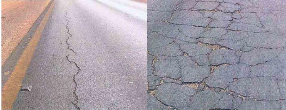
Figura 1. 1. Agrietamiento por fatiga.
