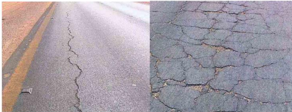
Figura 3. 6. Agrietamiento por fatiga (Garnica Anguas, Gómez López, & Sesma Martínez, 2002).
