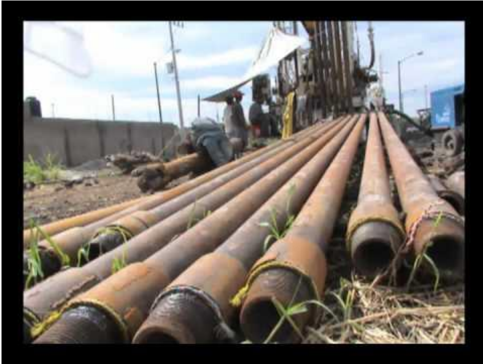
Fotografía. 3.6 Tubería de perforación.
