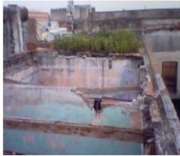
Losas colapsadas de azotea
