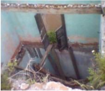
Losas colapsadas en segundo nivel
