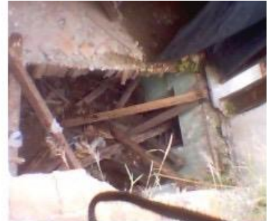
Losas colapsadas de entrepiso
