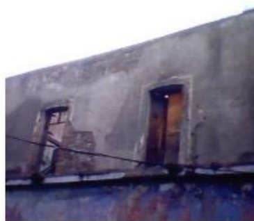
Pasillo colapsado lado poniente
