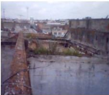
Losas colapsadas de azotea
