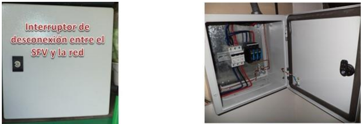
Figura 5.13 Interruptor de desconexión del SFV y la red de BT.
