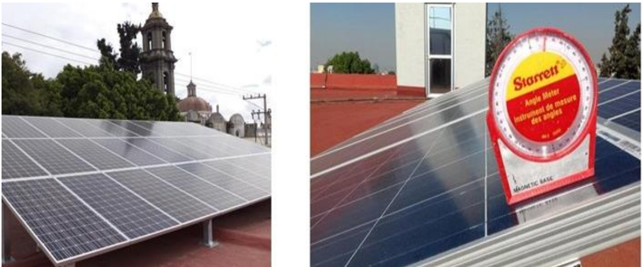
Figura 5.17 Inclinación de los Paneles Fotovoltaicos.
