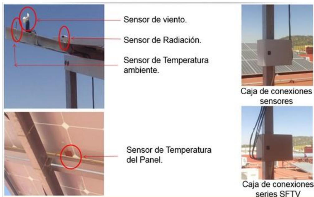
Figura 5.6 Sensores de Viento, Radiación, Temperatura Ambiente y del Panel.
