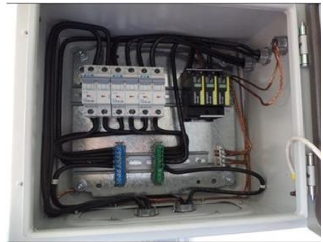
Figura 5.15 Interruptor del Inversor.
