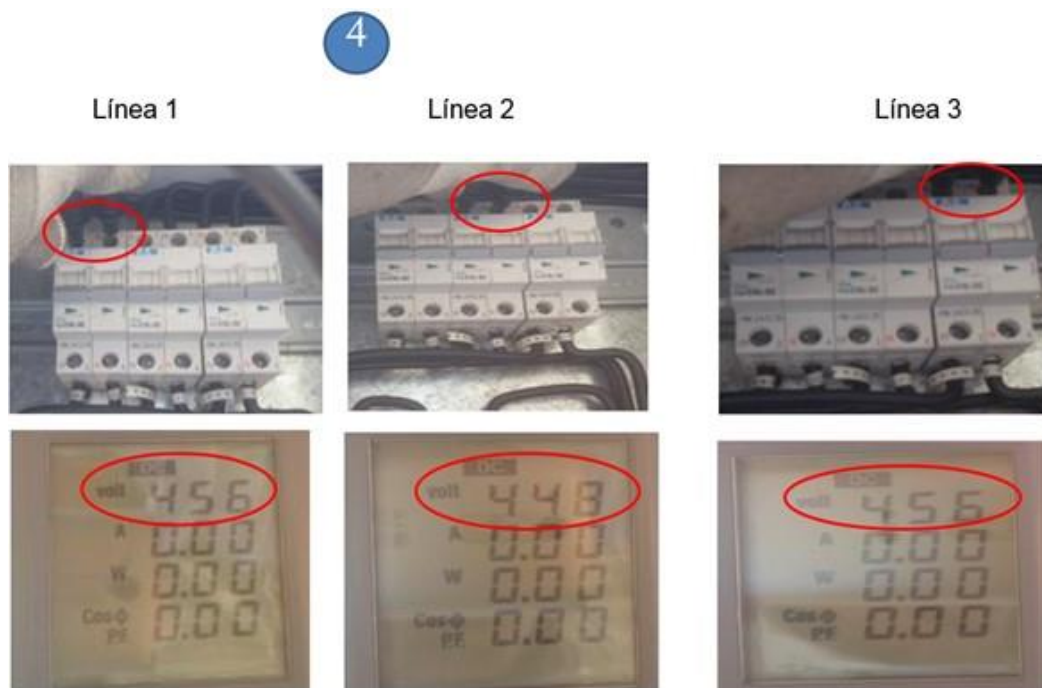
Figura 5.28 valores de los Voltajes en CD en las tres líneas.
