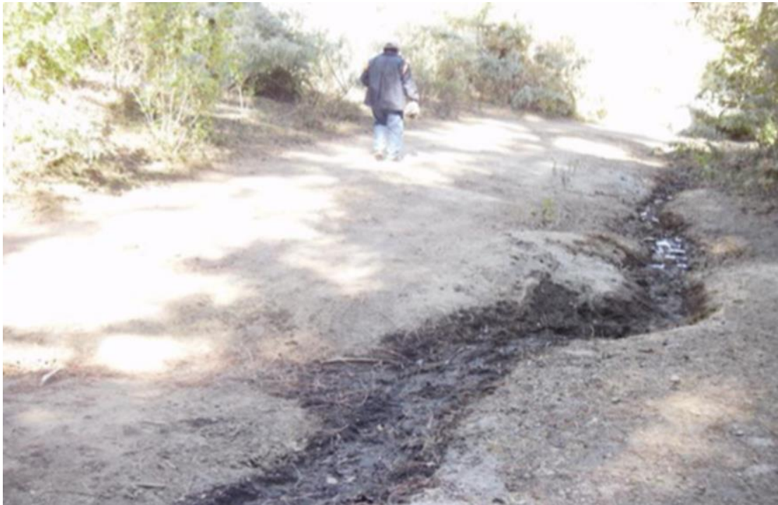
Ilustración 71: Servicios generales al sistema de abastecimiento de agua por manguera; de forma área y desnivel marcado en cruces de carretables y senderos presentando erosión y socavamiento, Fuente: Registro Fotográfico febrero 2016, Foto: Gonzalo A. Torres Z.
