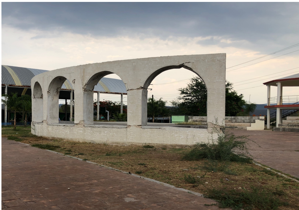
Parque dañado después de un año de su construcción. [Fotografía de Karla González]. (Junta Auxiliar San Francisco de Asís, 2019). Tehuiztingo, Puebla, México.
