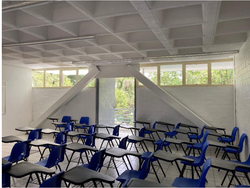
Figura 1.19. Conexión de contraviento excéntrico mediante placas soldadas en T, fijadas hacia la losa. Fuente autoría propia, 2022.
