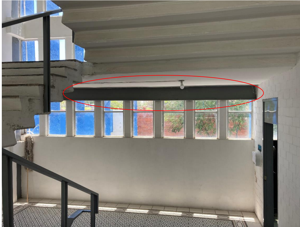
Figura 1.8. Fotografía que muestra las traves metálicas que soportan la escalera. Fuente autoría propia, 2022.
