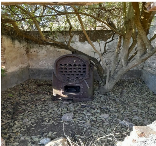
Fotografía 3. Bomba de leña ahora en desuso. Fuente: Autoría propia
