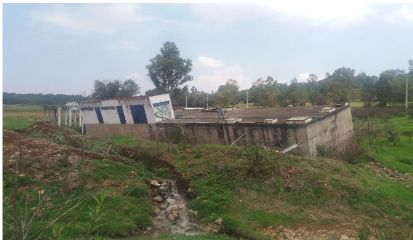
Fotografía 16. Planta de tratamiento abandonada y cauce desviado. Fuente: Autoría propia
