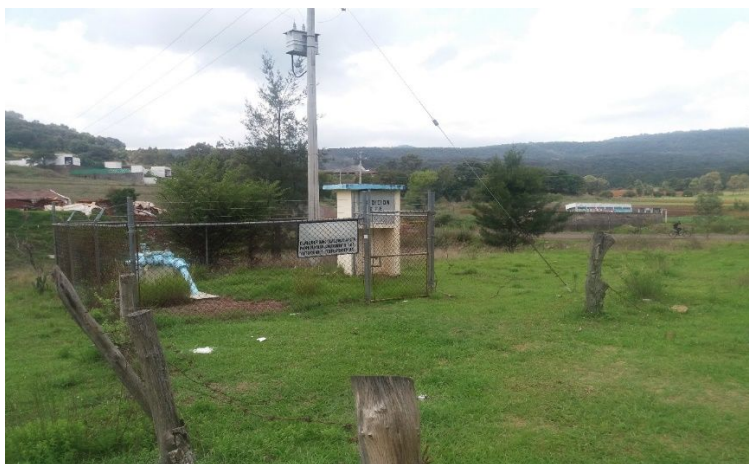
Fotografía 7. Pozo profundo. Fuente: Autoría propia
