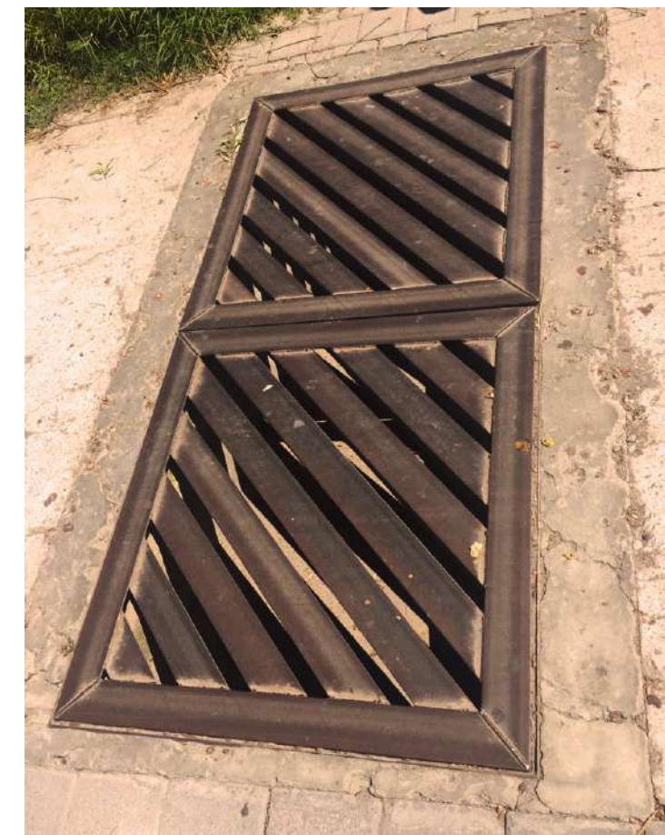
Figura 86. Alcantarilla existente en la Av. Reforma Norte, se observa la diferencia en altura entre esta y el pavimento que la rodea.
