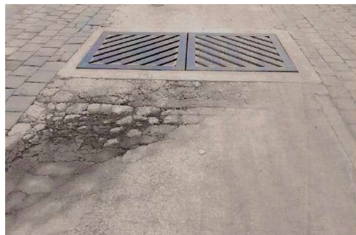
Figura 87. Alcantarilla existente en la Av. Reforma Norte colocada a un nivel superior del pavimento.
