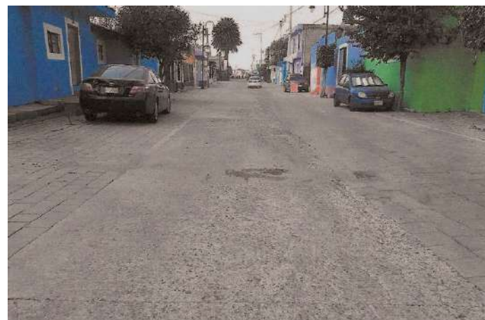
Figura 88. Pavimento actual en la Av. Reforma Norte.
