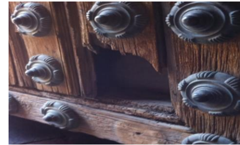
Imagen 10. Base de listón de cubierta, incompleto
