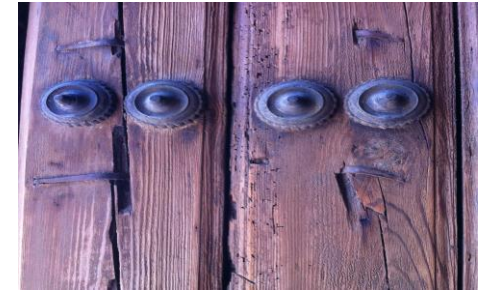
Imagen 7. Grieta en trayectoria de remaches estructurales
