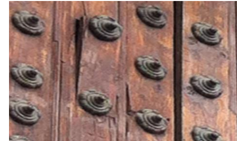
Imagen 12. Parcial desprendimiento de listón de cubierta exterior
