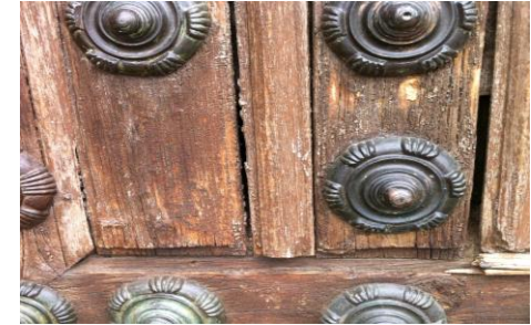
Imagen 6. Grietas en molduras de los listones de cubierta
