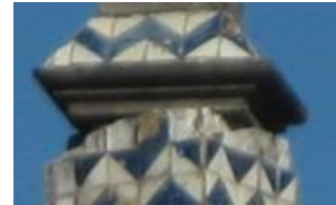
Imagen 8. Pérdida de piezas de talavera
