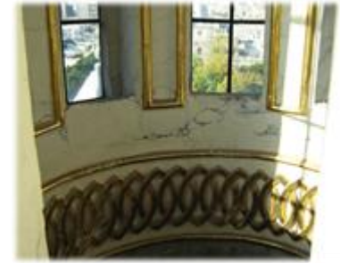
Imagen 12. Daños en pintura
