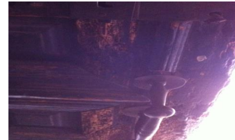
Imagen 22. Interior de portón con notable desgaste por afección de insectos
