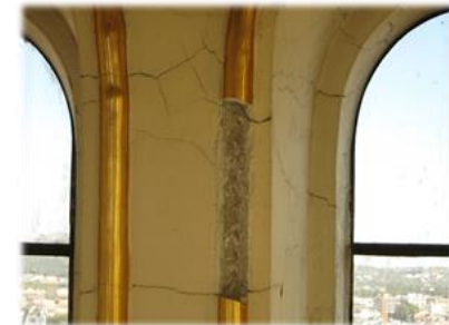
Imagen 11. Daños en molduras
