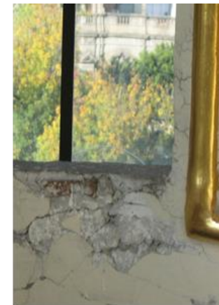
Imagen 10. Deterioros en recubrimientos
