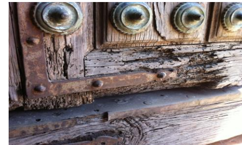
Imagen 11. Base de marco estructural, deteriorado por las termitas
