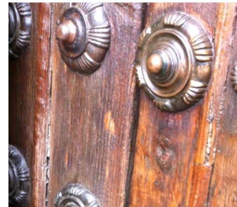
Imagen 18. Capas de barniz sobre madera y polvo en cubierta de madera
