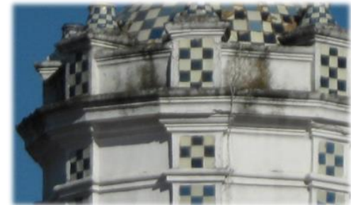
Imagen 1. Manchas en molduras
