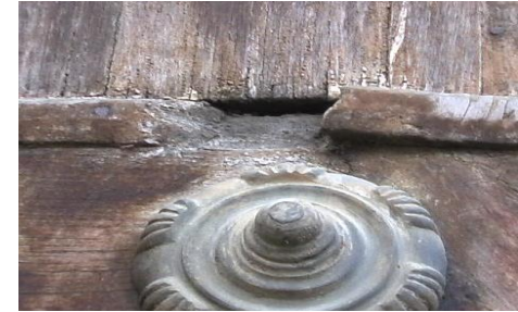
Imagen 9. Moldura de madera, torcida e incompleta
