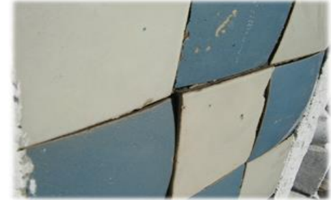
Imagen 7. Pérdida de juntas
