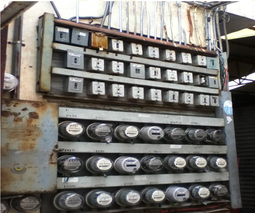
Malas condiciones de los medidores de luz servicio para valorar su estado. Fotografía de autor 24 de Septiembre 2013
