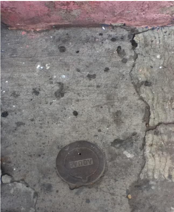
infraestructura y equipamiento urbano en condiciones deplorables
