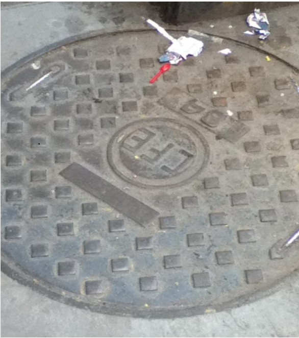
registros de luz en malas condiciones
